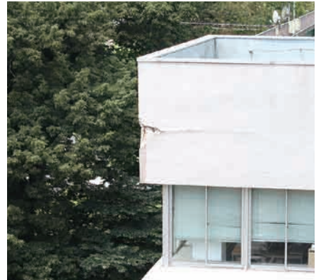
外壁モルタルにクラック発生
