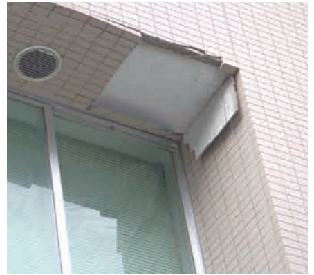
外壁タイルの剥離・剥落
