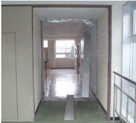
渡り廊下のエキスパンション・ジョイントが破損
