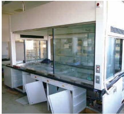
化学実験台が破損
