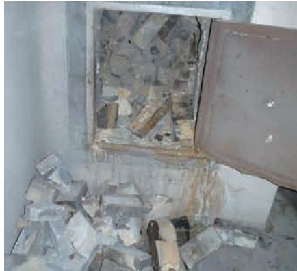
煙突の耐火レンガが剥落
